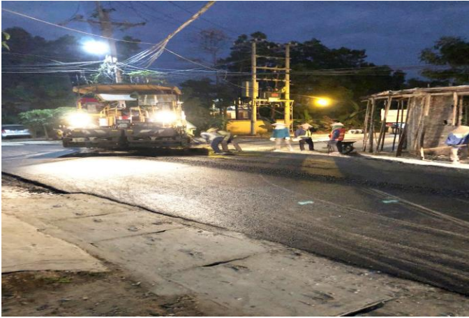
Trải thảm bê tông nhựa đường nội thị phường Hương Sơn (Ảnh chụp năm 2019)
