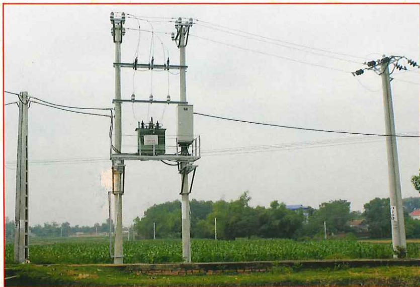
Trạm biến áp trên địa bàn xã
