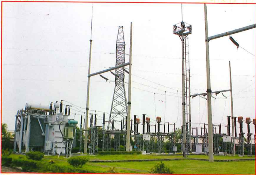
Trạm điện Sông Công trên địa bàn xã
