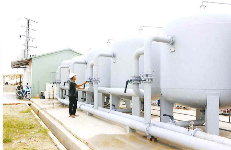
Hệ thống cấp nước với trang thiết bị hiện đại, đáp ứng nhu cầu tại các khu công nghiệp.
