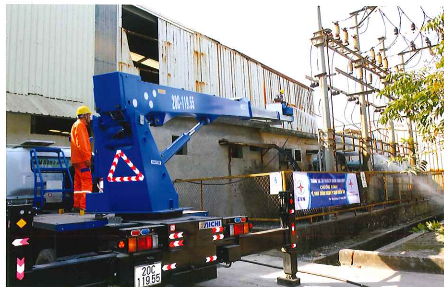
Đảm bảo an toàn điện lưới.
