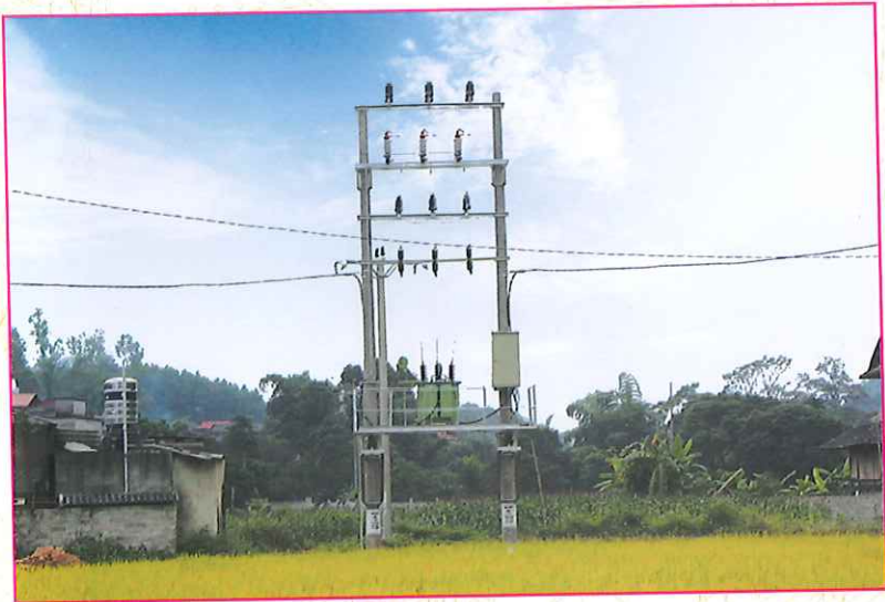
Trạm biến áp ở xã Cúc Đường
