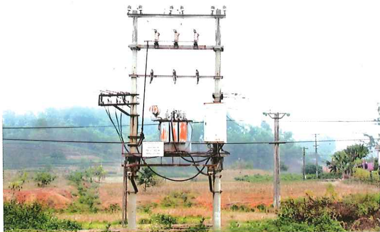
Trạm điện Trung Thành xã Vô Tranh xây dựng năm 1998
