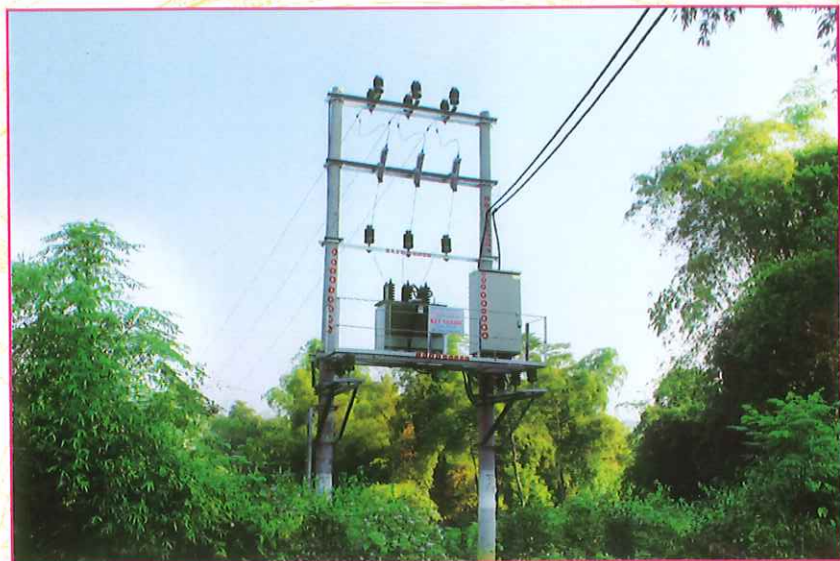
Các trạm biến áp đã cung cấp điện cho 100% hộ gia đình trong xã
