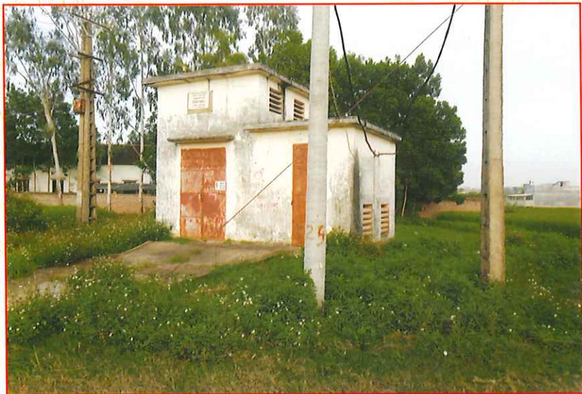
Trạm biến áp trên địa bàn xã
