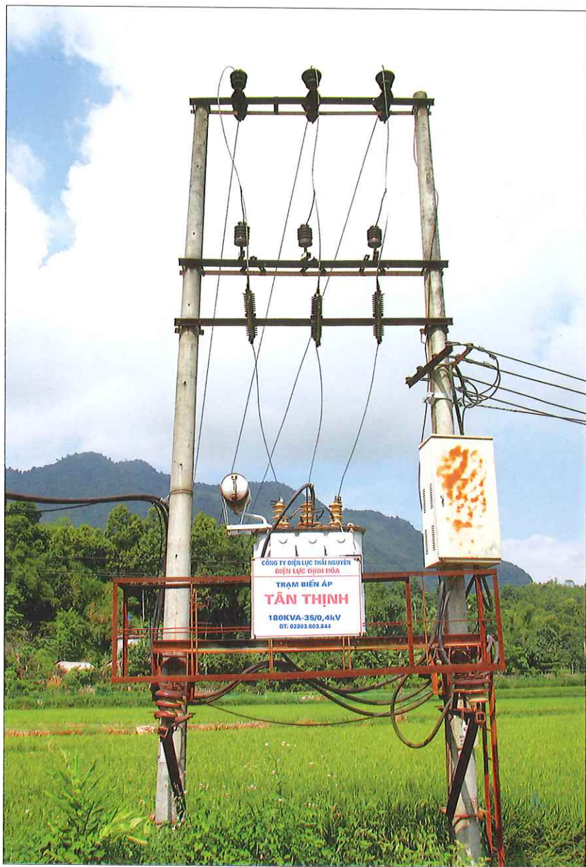
Trạm biến áp số 2 - xóm E ông Vang, Tân Thịnh
