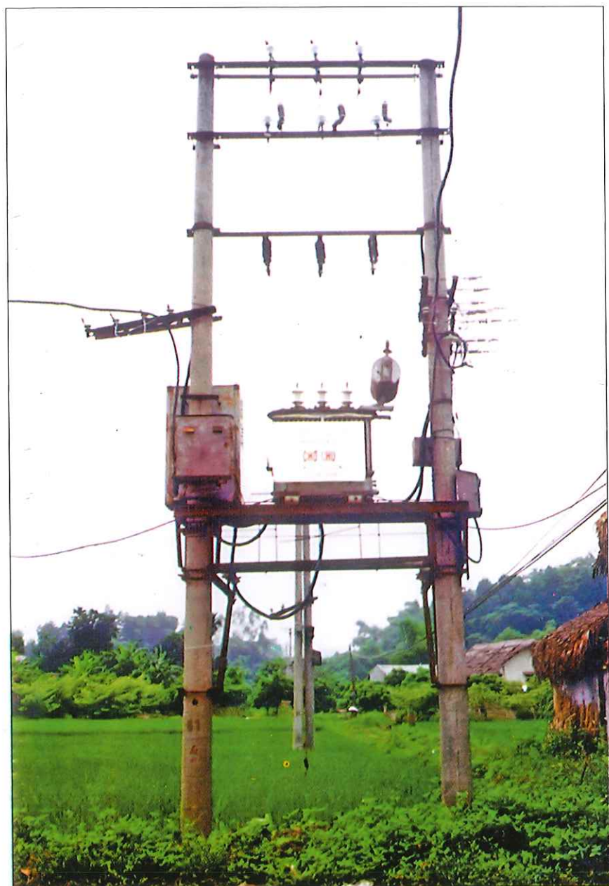
Trạm biến áp Chợ Chu năm 1993
