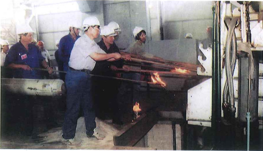
Các đồng chí lãnh đạo Công ty Gang thép cùng chuyên gia Trung Quốc châm lửa khai lò siêu cao công suất 30 tấn/mé.
