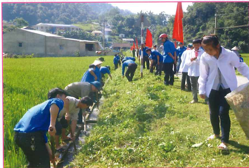
Đoàn Thanh niên cùng nhân dân trong xã tổ chức nạo vét kênh mương phục vụ tưới tiêu (năm 2015)
