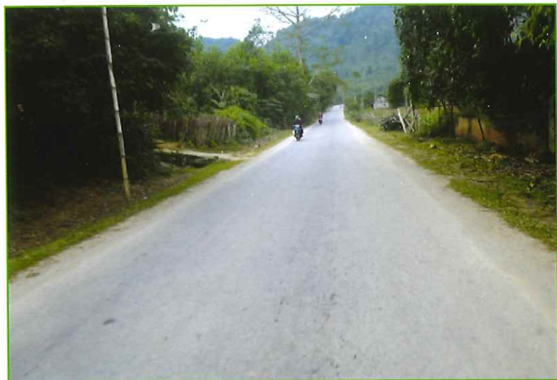
Đường 279 đoạn qua xã Bành Trạch
